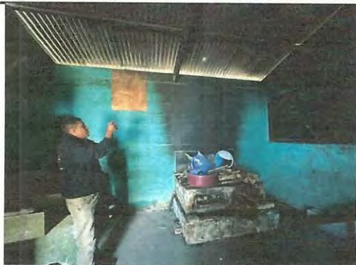
Foto 1: ESTADO ACTUAL DE LA COCINA RURAL Y EL PISO EN MAL ESTADO
