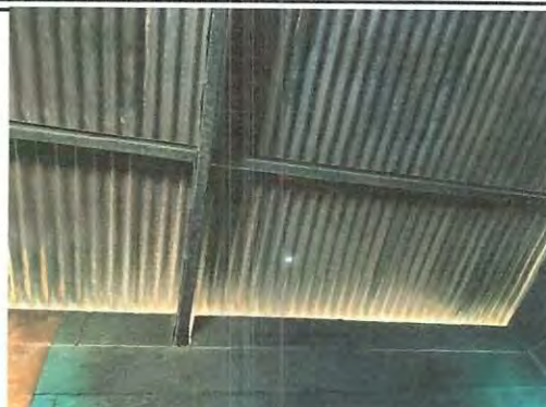
Foto 2: ESTADO ACTUAL DEL TECHO CON GOTERAS Y DAÑOS EN LÁMINA
