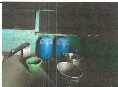
Foto 4: ESTADO ACTUAL DEL DETERIORO DE LA PINTURA EN PAREDES
