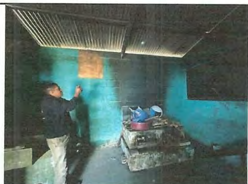
Foto 5: ESTADO ACTUAL DE LA PILA
